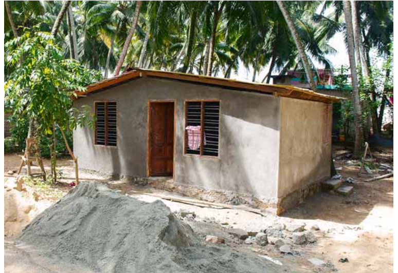
Besser lernen: Der Verein kümmert sich nicht nur um neue Projekte, sondern hält bereits renovierte Schulen in Gang
